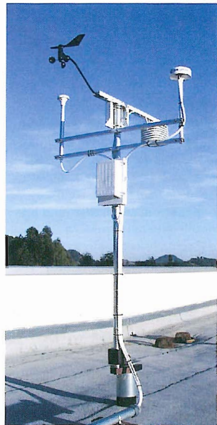
Antenna di emissione dei segnali, situata sopra un edificio.
